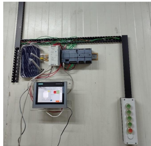
Figura 5. Elementos físicos para control (PLC, HMI y Botonera)
